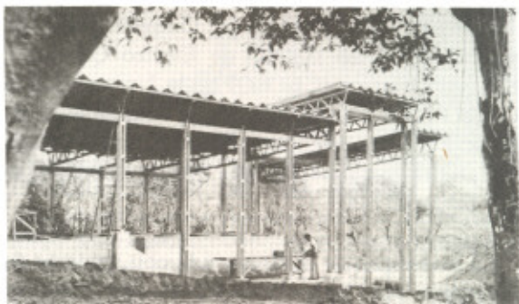
La construcción de una minidestilería en San Pedro (finca de la Universidad de Costa Rica) avanza rápidamente.
